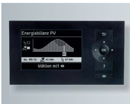
Regelung Vitotronic 200 – Anzeige von Solarertrag und Anteil des selbst genutzten Stroms
